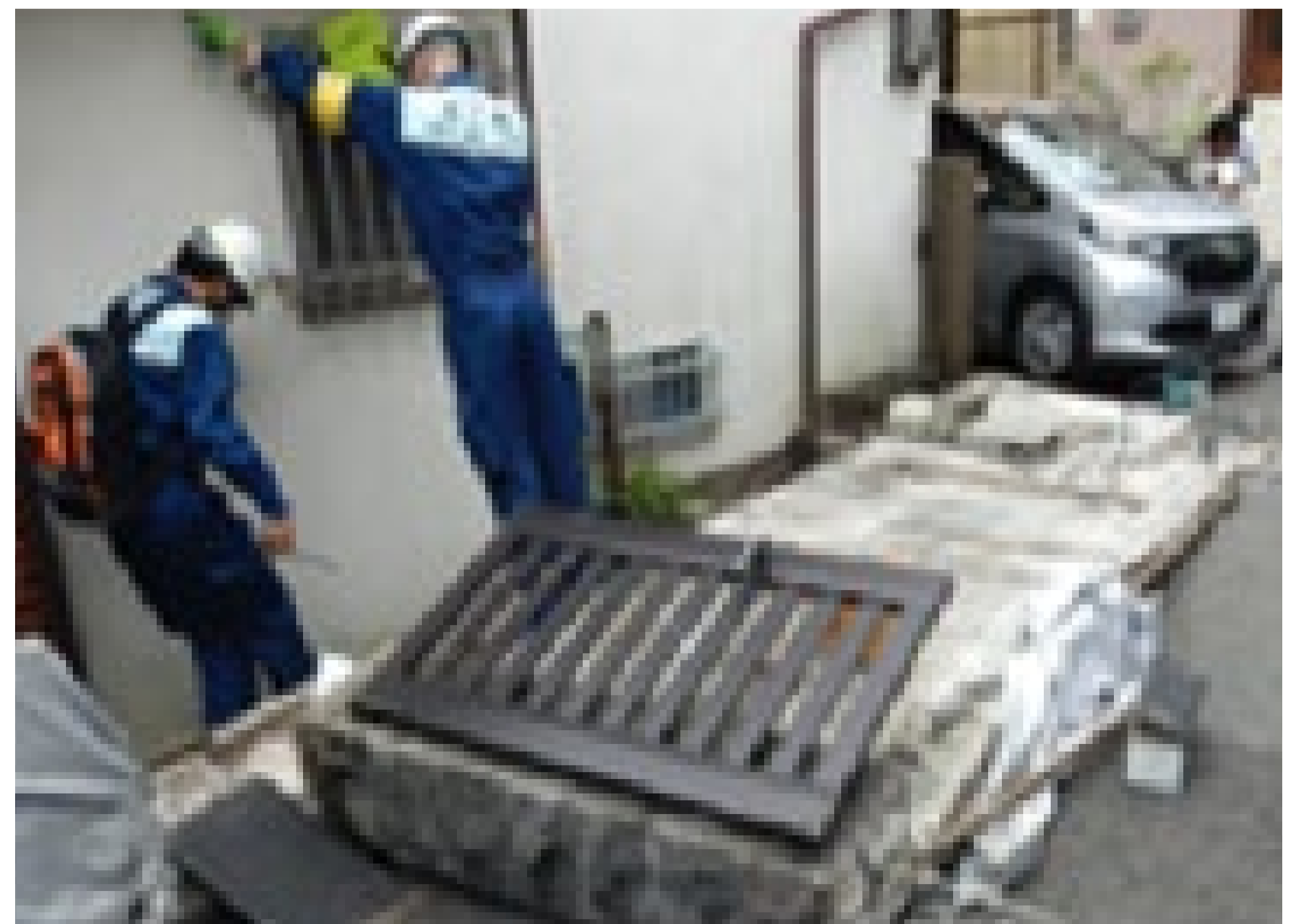
転倒したブロック塀
