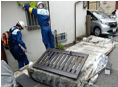
転倒したブロック塀
