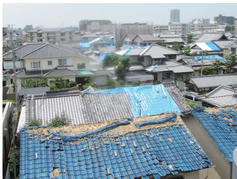
屋根瓦に被害のあった住宅
