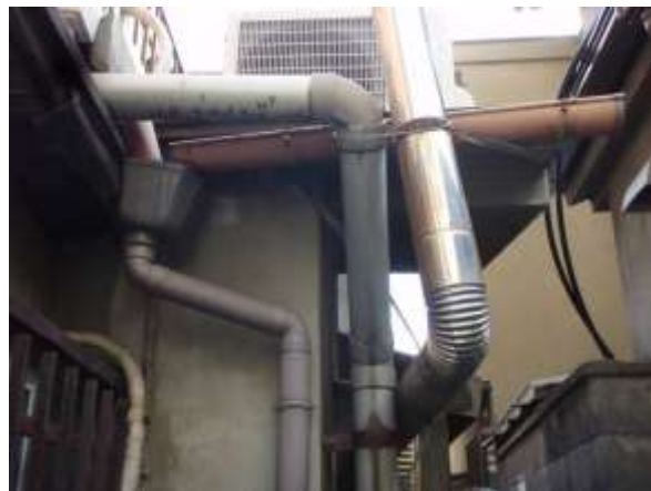
toi-5. 樋がずれていて、外壁に雨水がかかっている
